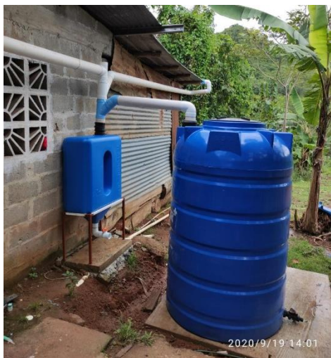
Figura 1. Sistema de cosecha de agua de lluvia
