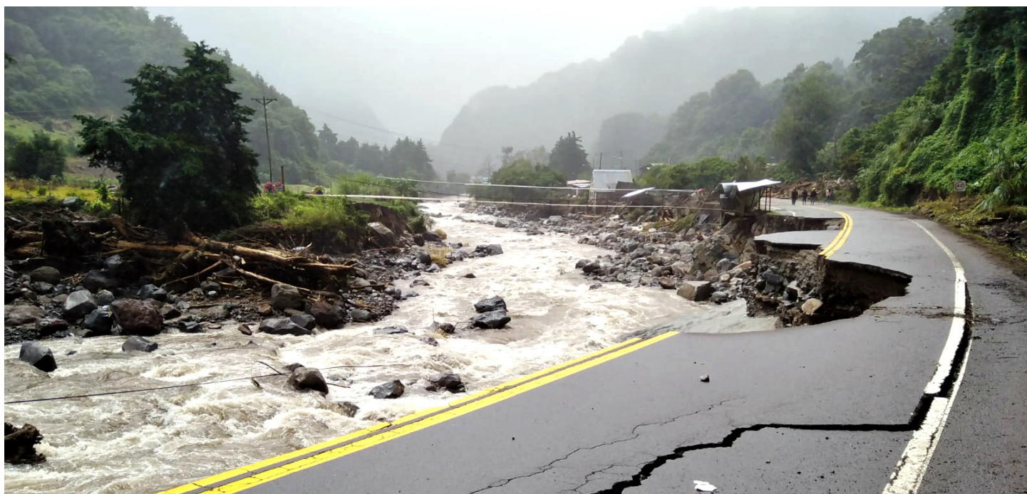
Fotografía 5. Daños por inundación del río Chiriquí Viejo, Cerro Punta, Chiriquí. Fuente: MiAMBIENTE 2020
