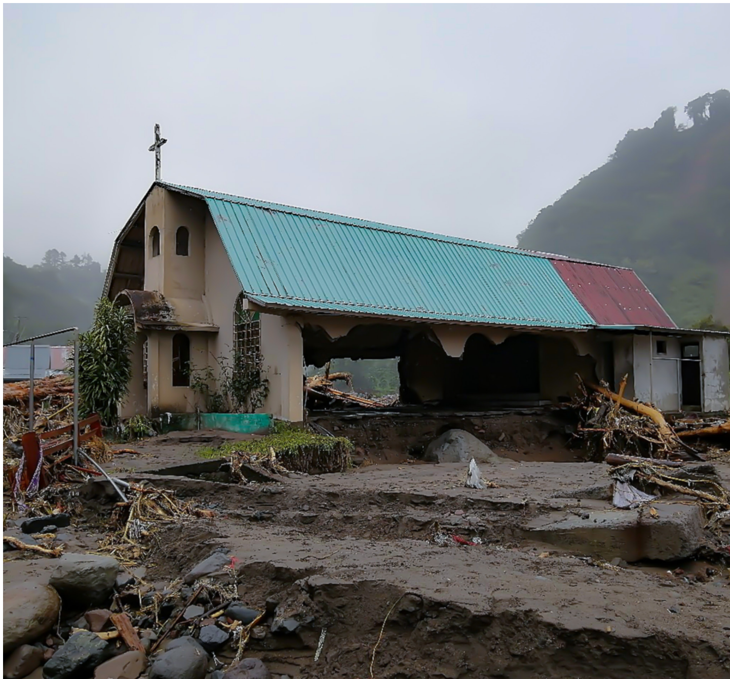
Fotografía 10. Daños tras la inundación del río Chiriquí Viejo en Cerro Punta, Chiriquí. Fuente: SINAPROC (2020)
